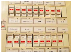
部屋・器具別に回路分けされた分電盤の例
