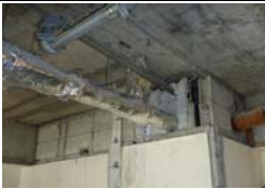
天井裏配管の例
