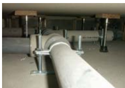
床上配管の例
