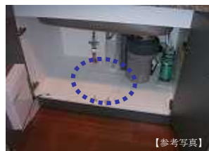
キッチンシンク下の点検口
